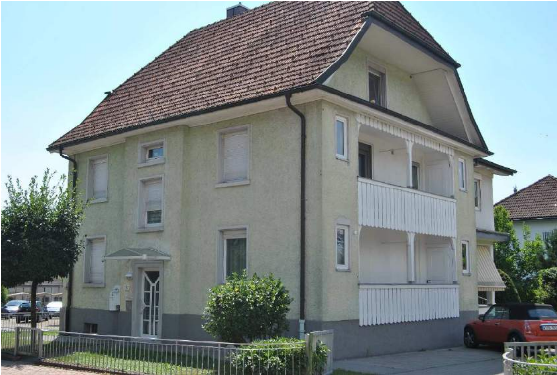
Bsp. Gebäudebestand mit baulichen Mängeln
