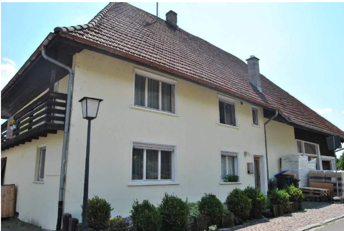
Bsp. Gebäudebestand mit baulichen und energetischen Mängeln
