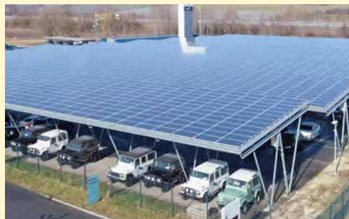
Die Photovoltaik-Dächer der Firma Auer in Stockach dienen auch zum Schutz der Fahrzeuge vor Hitze und Unwetter.
