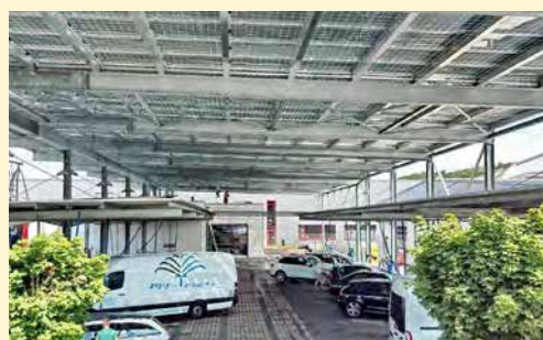
Solardach eines Waschparks in Tübingen
